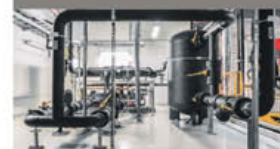
امکان تامین کلیه شیرآلات مرتبط با شبکه تولید و توزیع آب گرم در موتورخانه The possibility of supplying all the valve related to the steam generation and distribution network to the boiler room
